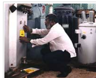
Etiquetaje de un transformador con PCB
