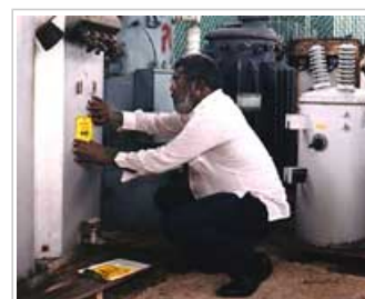
Etiquetaje de un transformador con PCB
