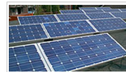
Los gobiernos deben mejorar los programas de despliegue para tecnologías como la energía solar. Fuente: Johan Bolhuis
